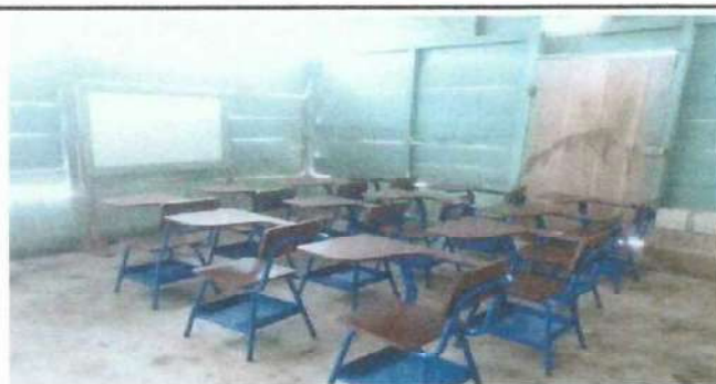
Foto 4: Se observa que el salón de clases presenta poca iluminación, lo que afecta las condiciones adecuadas para el desarrollo de las actividades escolares.
