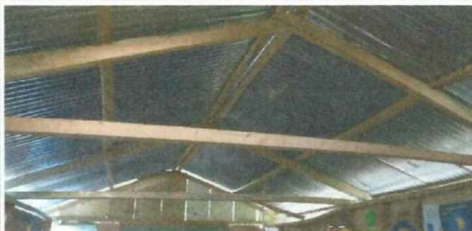
Foto 2: Se observa que la estructura del techo se encuentra en mal estado debido al desgaste natural de la madera, lo que ha debilitado su resistencia, en época de lluvias se filtra el agua.
