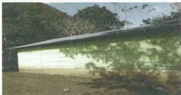
Foto 1: Se observa que la pintura de la escuela se encuentra en mal estado, presentando desgaste, decoloración y desprendimiento en varias áreas.
