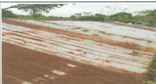
Foto 3: Se identifica que la cubierta de láminas se encuentra en mal estado, presentando deterioro y en época de lluvia se filtra el agua.
